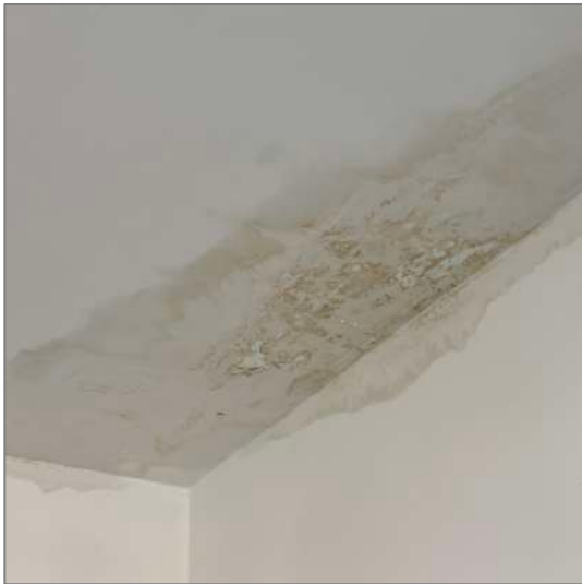
FOTO 14 - Infiltrazioni dal coperto
