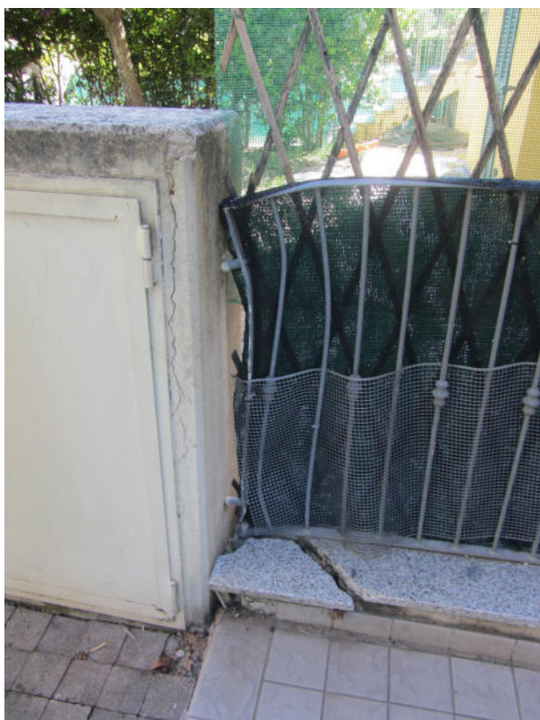
FOTO E.06_ ESTERNO_cedimento terreno scoperto comune
