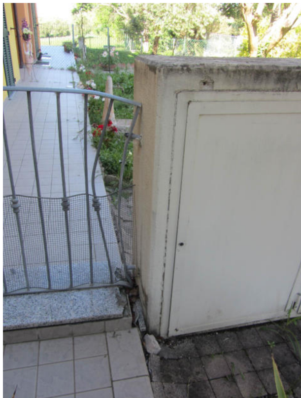
FOTO E.07_ ESTERNO_ cedimento terreno scoperto comune
