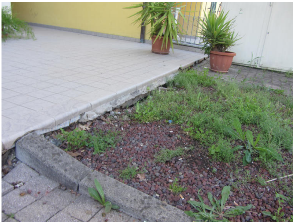
FOTO E.05_ ESTERNO_cedimento terreno scoperto comune
