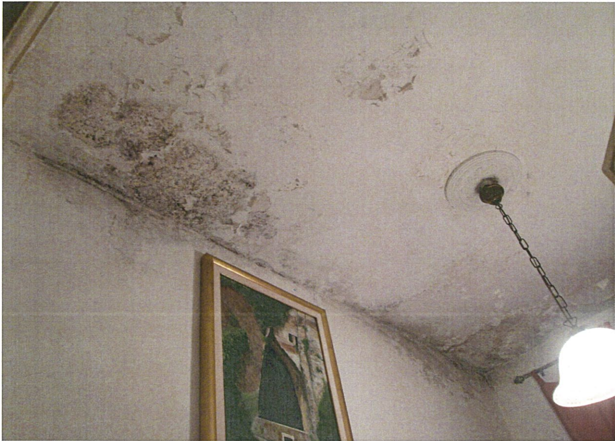
Foto n.12 Stanza da bagno sul soffitto si evidenziano macchie di muffe prodotte dalla rottura di tubazioni.
