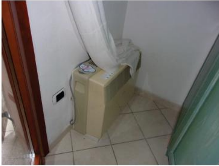
FOTO N. 32, Fancoil a pavimento
