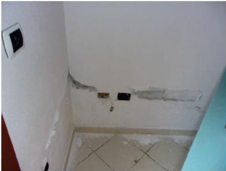
FOTO N. 25, particolare delle efflorescenze nel vano Soggiorno
