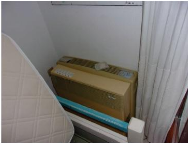
FOTO N.30, Fancoil a pavimento
