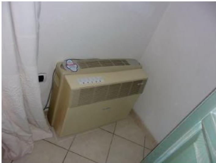
FOTO N. 33, Fancoil a pavimento
