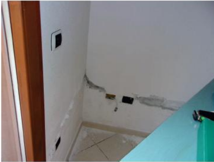
FOTO N.24, particolare delle efflorescenze nel vano Soggiorno
