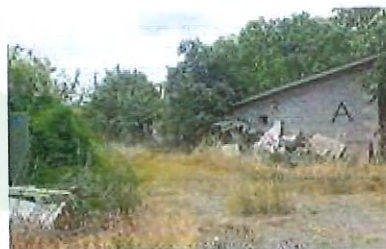
Una delle parti del tetto crollato e l'area di terreno adiacente all'edificio in stato di abbandono.
