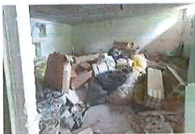
Una stanza della casa in stato di abbandono con detriti e materiali incongrui da smaltire e bonificare.
