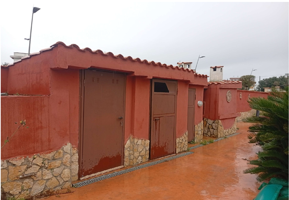
Vani tecnici a servizio piscina – spogliatoio – servizio igienico – locale tecnico e forno
