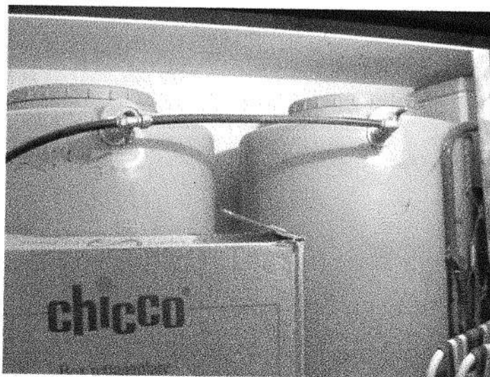
Riserva idrica posta nel vano cantina
