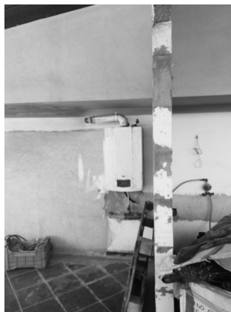
Foto 21 _terrazza_ posizione caldaia
