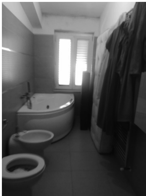
Foto 12_ bagno camera 1 (inagibile)
