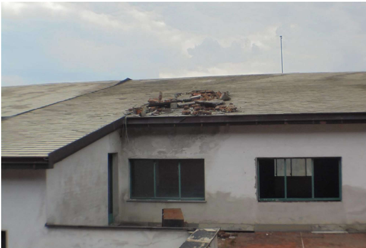
Foto 58 – Dettaglio della porzione del tetto distrutto
