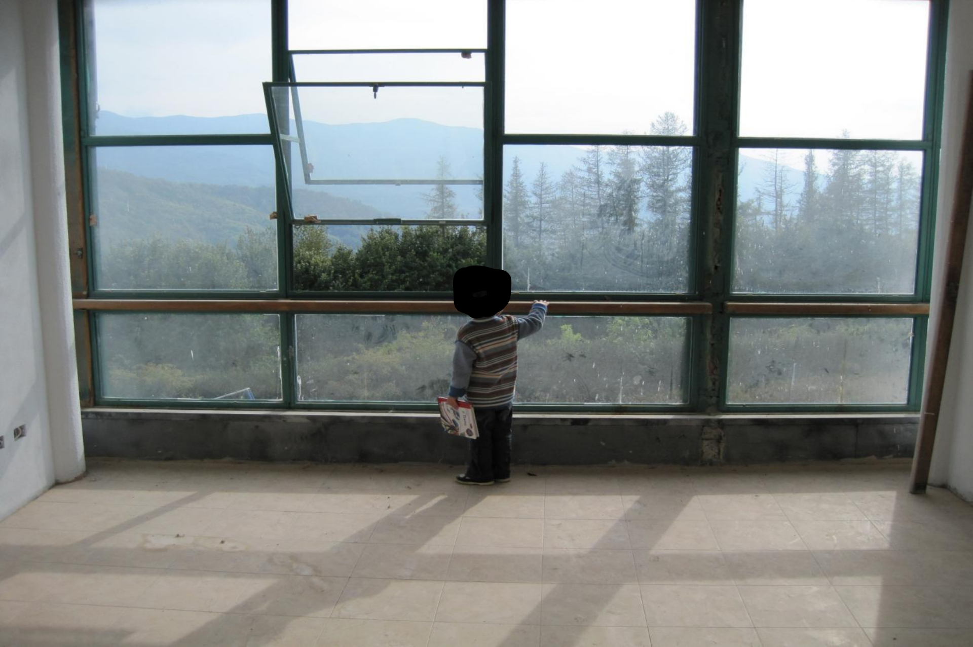
Un altro serramento che un bambino da solo non può aprire Il corrimano crea distanza dal serramento, disincentiva dall'arrampicarvisi
