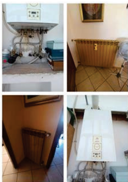
PROC. ESPEC. N°53/2024 - RILIEVO FOTOGRAFICO DETTAGLIO F. CO. IN UN'A. FINITO IN A. VILLAPIANA OVE È POSTO AL PIANO 1° APPARTAMENTO IN TRATTAZIONE - RINNEVA CALDAIA BUVALE + RAGATORI IN ALLUMINIO
