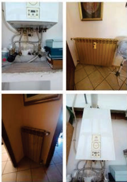
PROC. ESPEC. N°53/2024 - RILIEVO FOTOGRAFICO DETTAGLIO F. CO. IN UN A. PIANO 1° A VILLAPIANA OVE È POSTO AL PIANO 1° APPARTAMENTO IN TRATTAZIONE - RINNEVA CALDAIA BUVALE + RAGATORI IN ALLUMINIO
