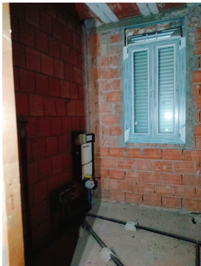
FOTO 14 – P.2°: Servizio igienico 2
