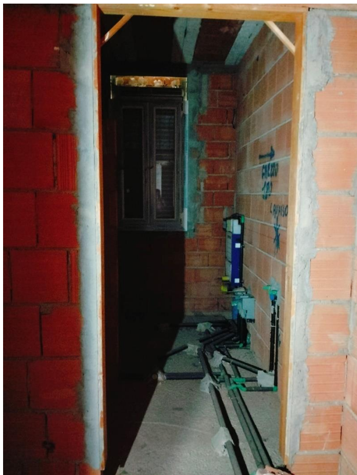
FOTO 12 – P.2°: Servizio igienico 1
