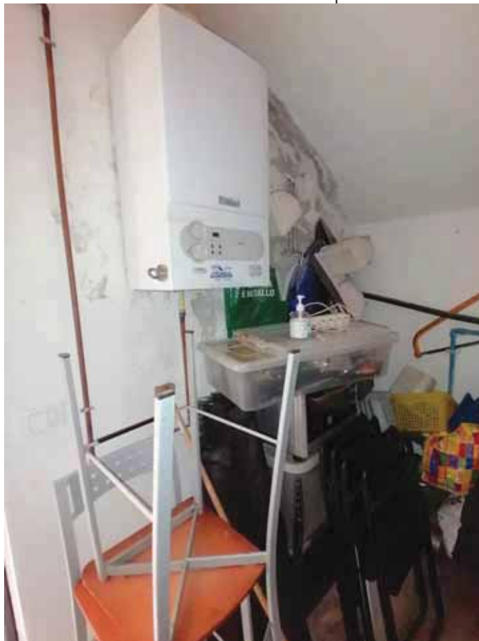
FOTO N°26: Vista interna del locale caldaia al piano seminterrato (2/2).
