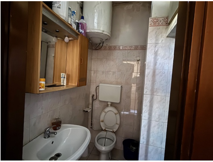
bagno cieco (difformità rispetto alla scheda catastale)
