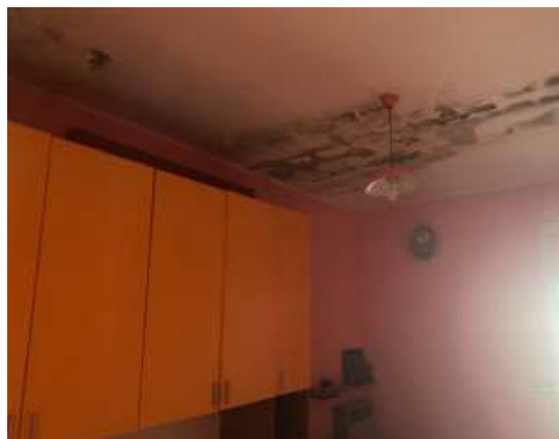
Vista Interna n.3 – Locale Letto infiltrazioni soffitto
