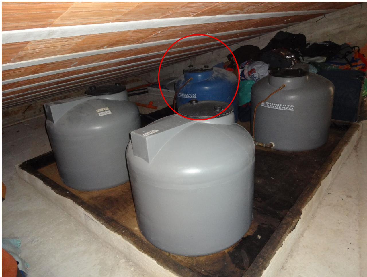
Foto 7-Vasche idriche ubicate nel sottotetto condominiale (lato destro salendo le scale). La vasca cerchiata in rosso è a servizio dell'appartamento costituente il lotto.
