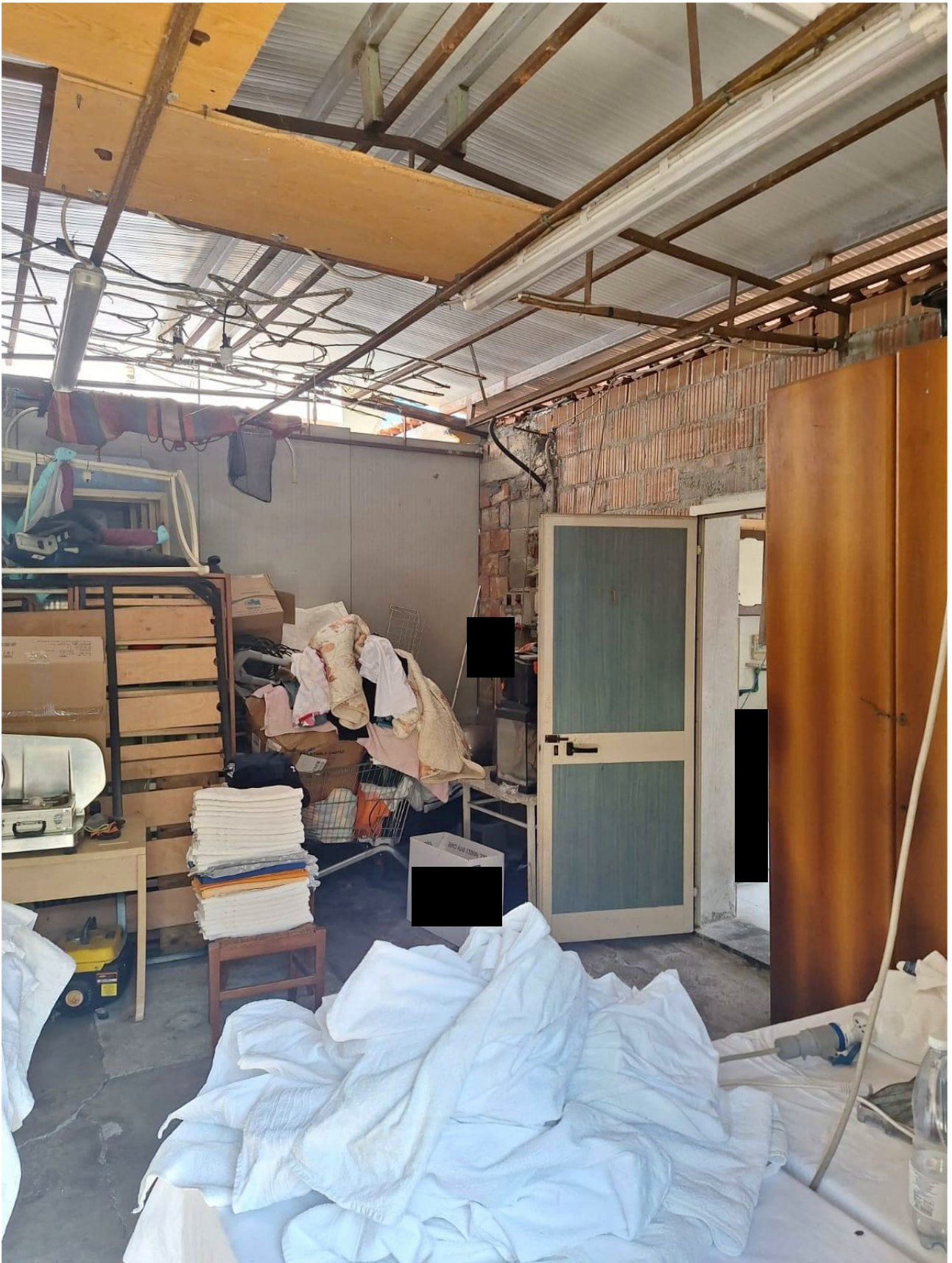
Manufatto esterno di pertinenza da rimuovere
