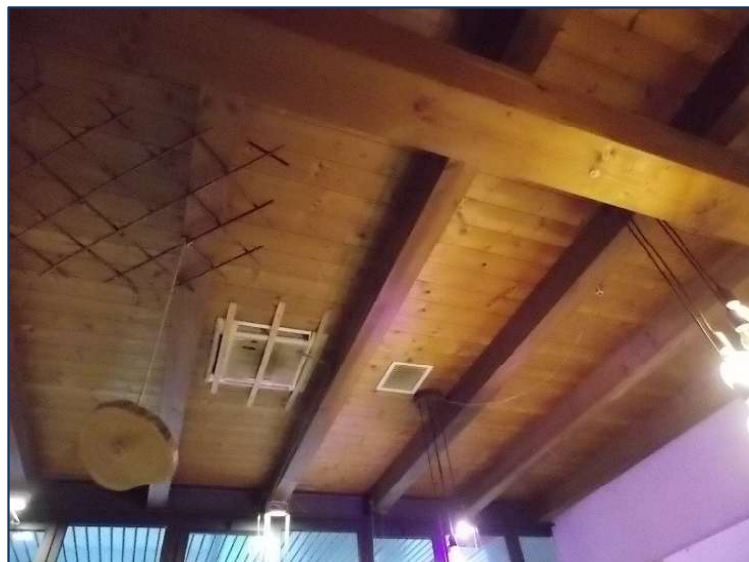
Soffitto travato con impiantistica (ventilazione e condizionamento)
