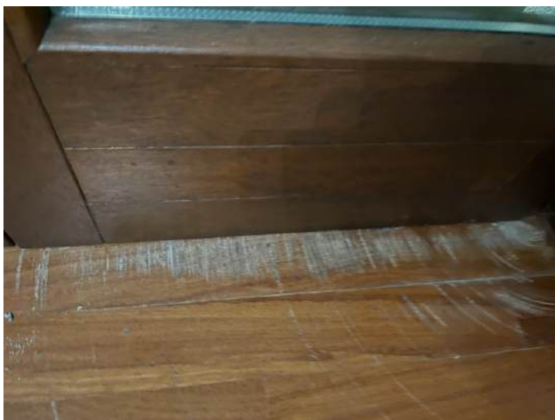
25 – vista pavimento in prossimità della porta finestra della camera
