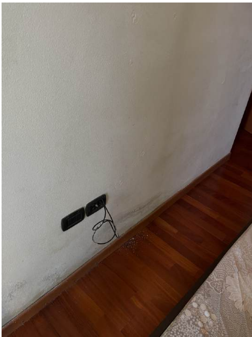
25 – vista infiltrazioni parete tra camera e bagno
