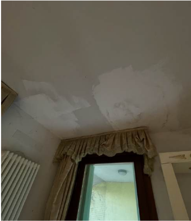
9 – vista infiltrazioni dal piano primo
