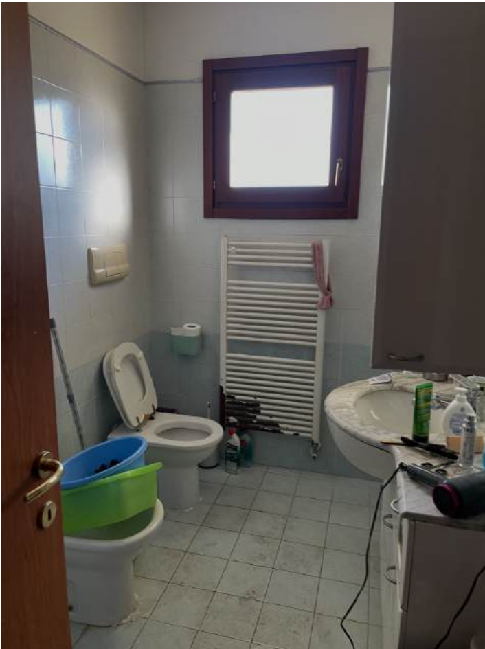
22 – vista bagno lato est con perdite
