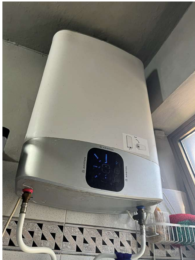
28_dettaglio caldaia bagno
