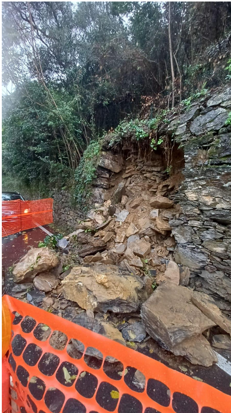
Foto n 29 Documentazione fotografica del terreno ad uliveto: vista sul recente crollo del terreno nella zona di Marina di Bardi i cui detriti hanno invaso il sedime stradale della SS1 Aurelia come si evidenzia nella comunicazione inviata dal Comune di Zoagli al proprietario del terreno.
