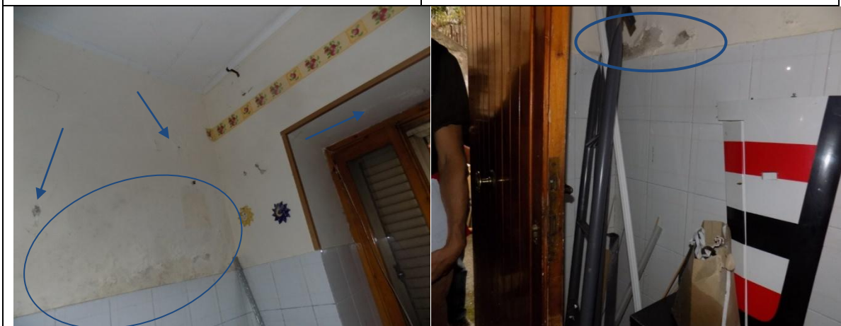
Rilevamento fotografico CTU del 16 e 28 luglio 2025: Ulteriori viste in particolare dell'ambiente unico Cucina/Pranzo laddove risulta evidente lo stato prolungato di abbandono, con presenza di fenomeni di umidità ed esfoliazioni lungo le mura perimetrali non piastrellate (cerchi e frecce blu).
