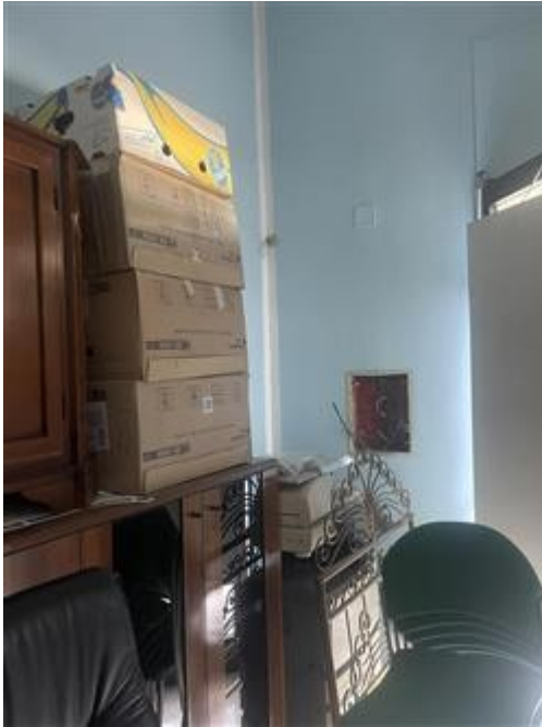
posizione attuale del quadro elettrico
