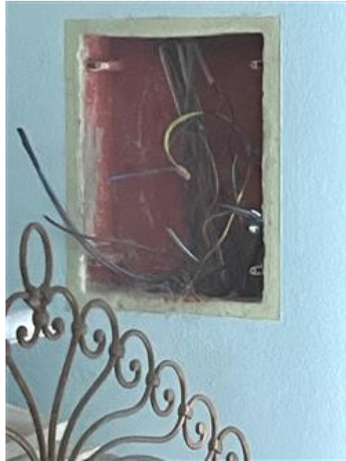
quadro elettrico completamente mancante
