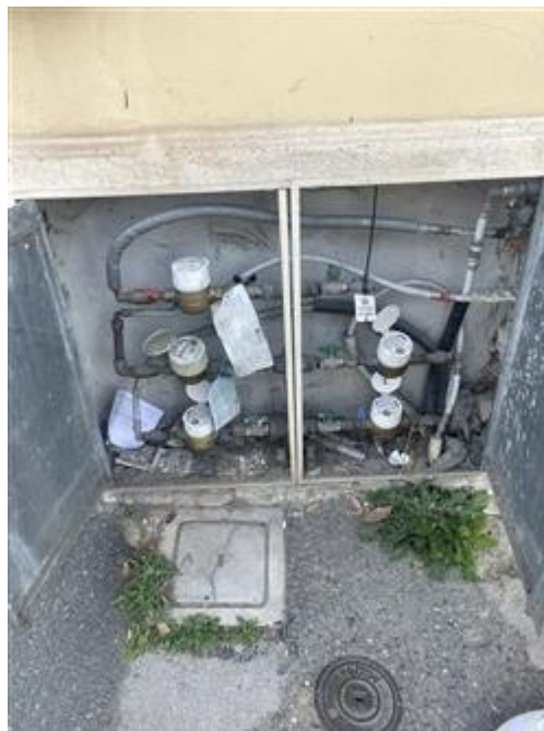
vano contatori attuale
