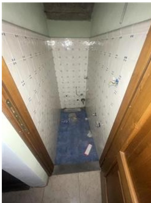
Locale igienico attualmente privo di sanitari
