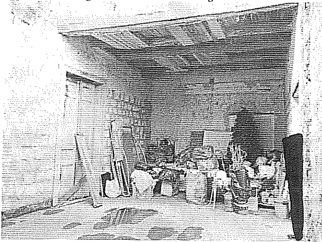
FOTO N. 1: la ripresa mostra gli oggetti depositati nel lotto n.1. Il solaio intermedio tra il I ed il II livello, come rilevabile dal fotogramma, è stato parzialmente demolito e pertanto attualmente ne esiste solo una porzione.
