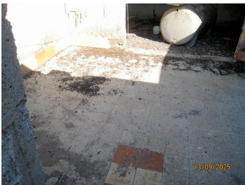
è sfondellato (foto n. 37-40).
