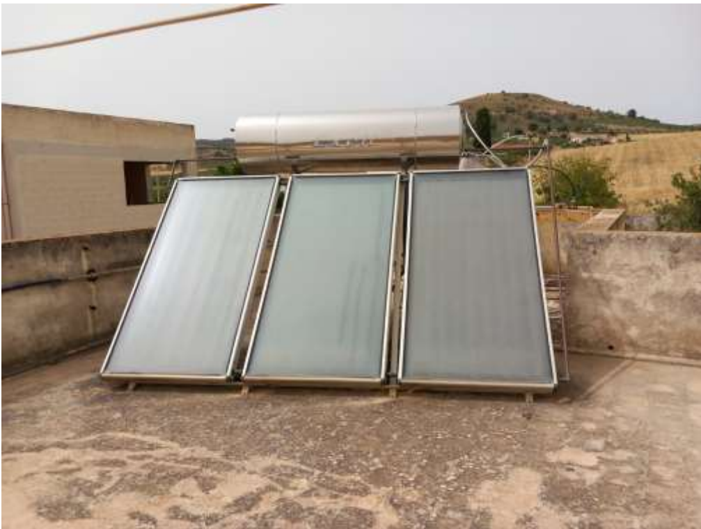
Foto n.25 Vista dei pannelli solari
