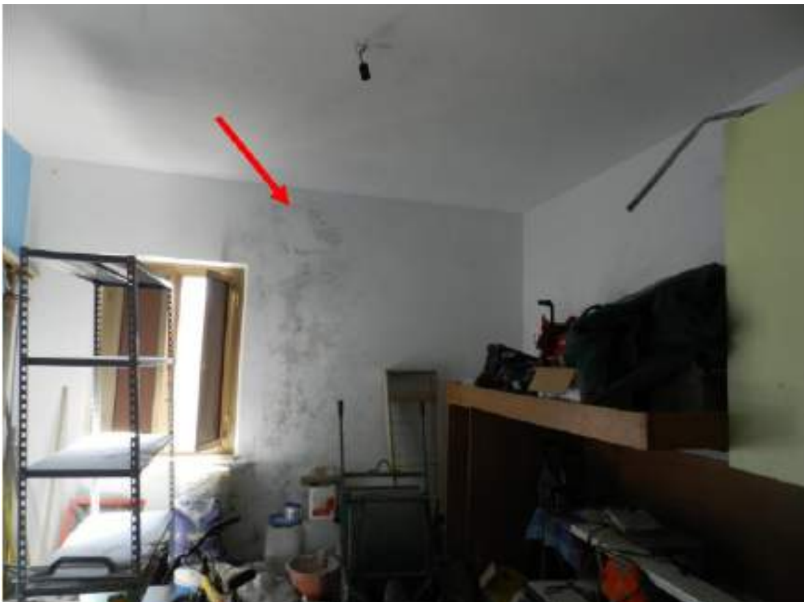
FOTO N.6 – Vista del vano al piano primo del LOTTO 1 in pessimo stato d'uso manutentivo
