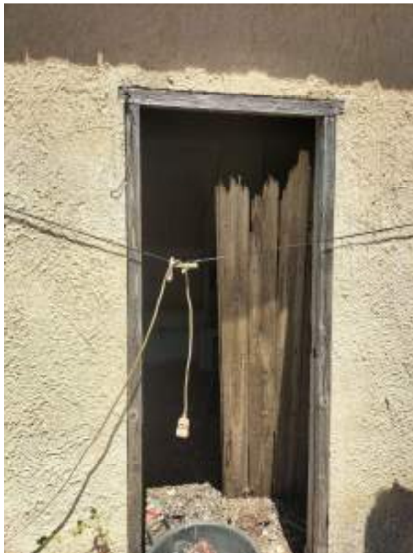
FOTO N.15 – Vista del pessimo stato d'uso manutentivo della porta d'accesso al locale di sgombero
