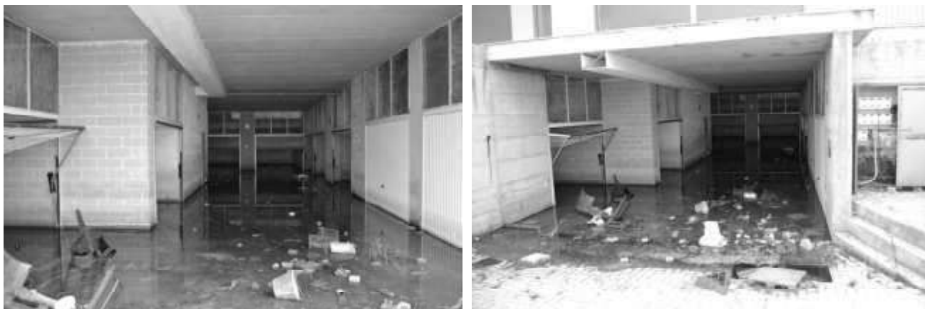
Immagini dell'allagamento del livello seminterrato e dello stato di degrado della struttura
