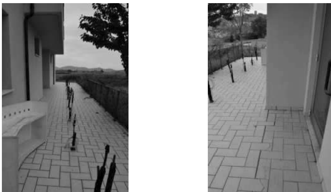
Immagini del cedimento della soletta presente sul retro del fabbricato
