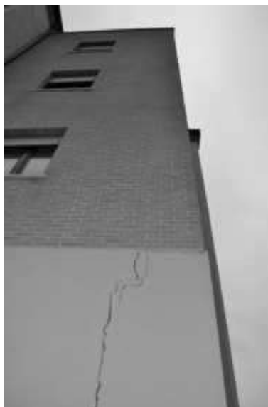
Immagini della lesione verticale per tutta l'altezza dell'edificio (Prospetto Sud)
