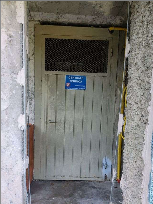
Fig. 43- Ingresso locale caldaia comune.
