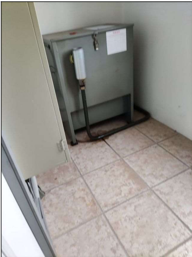
Fig. 39- Sala macchine ascensore sulle scale.
