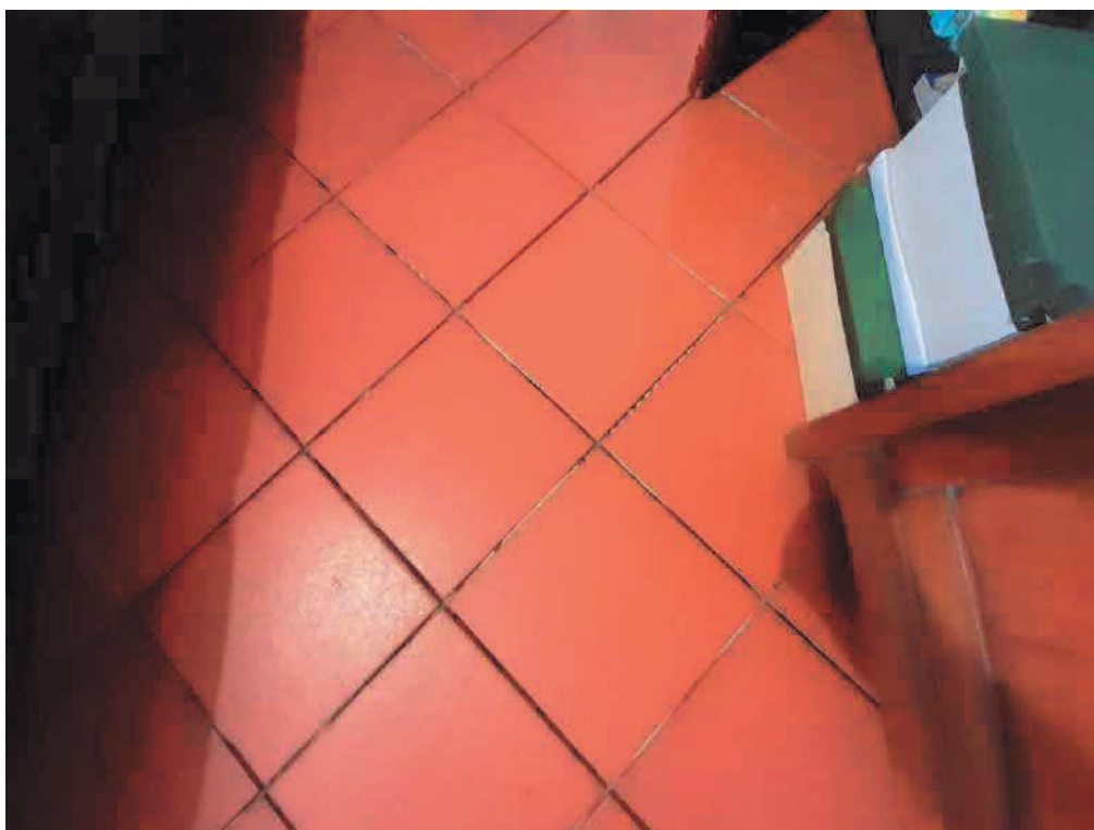
Particolare della pavimentazione priva di stuccatura delle fughe
