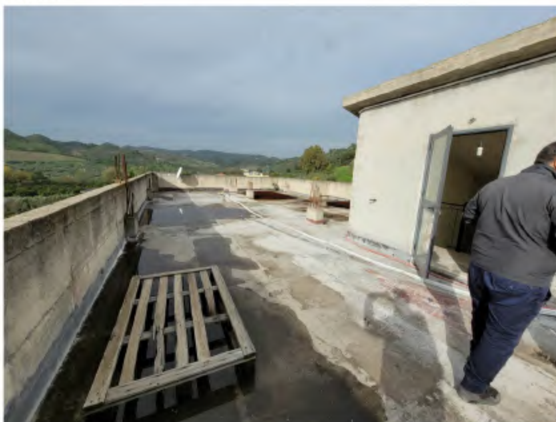
Foto n. 53. Edificio individuato al Catasto Fabbricati dalla particella 516 foglio 10: lastrico-solare di copertura con ristagni d'acqua sulla guaina impermeabilizzante del piano di calpestio
