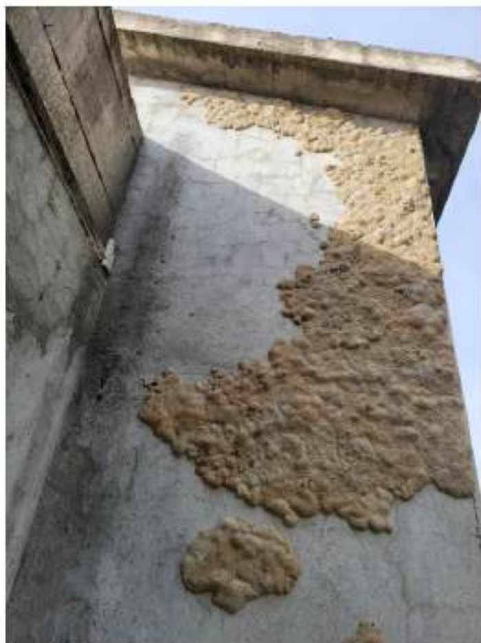
Foto n. 6. Fabbricato oggetto di causa: fessurazioni dell'intonaco esterno ed efflorescenze nella parte superiore della parete lato est del vano scala
