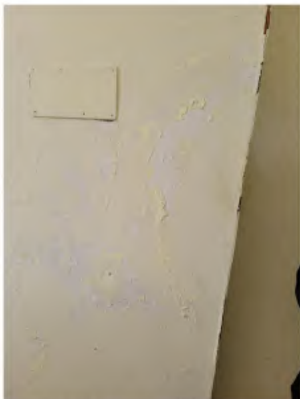
Foto n. 52. Edificio individuato al Catasto Fabbricati dalla particella 516 foglio 10: vano scala comune con macchie di umidità e rigonfiamenti della tinteggiatura sulle pareti esterne
