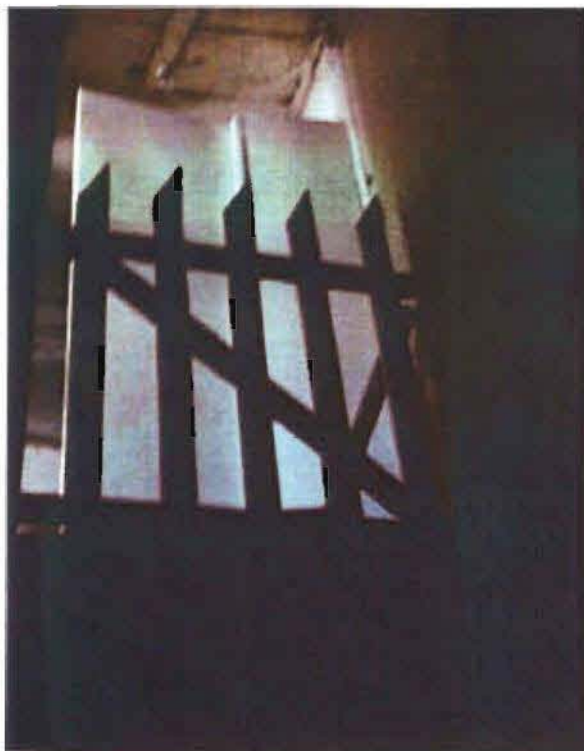
foto n°25 _Particolare vecchio vano scala collocato nel disimpegno del 1P (direzione scala piano superiore)
