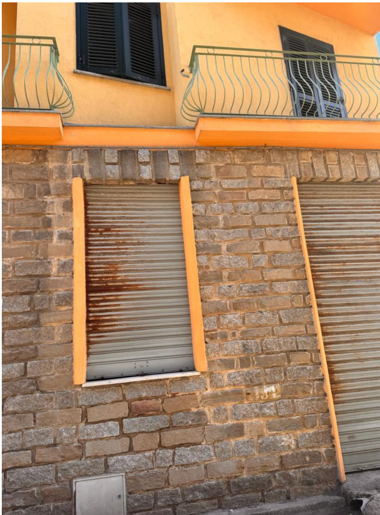
Foto 17: Vista esterna del garage a Piano Terra e dell'appartamento al Piano Primo
