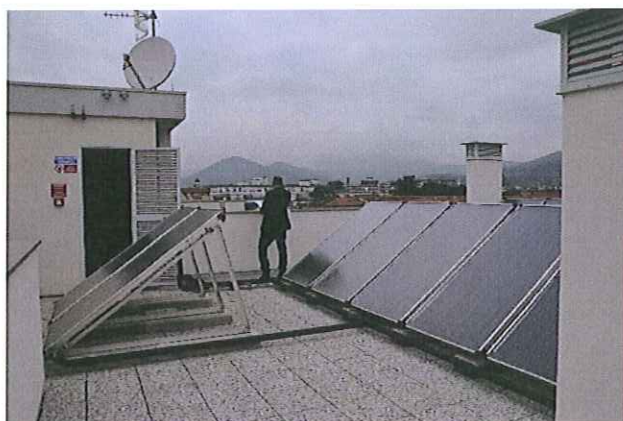
Pannelli solari in copertura
