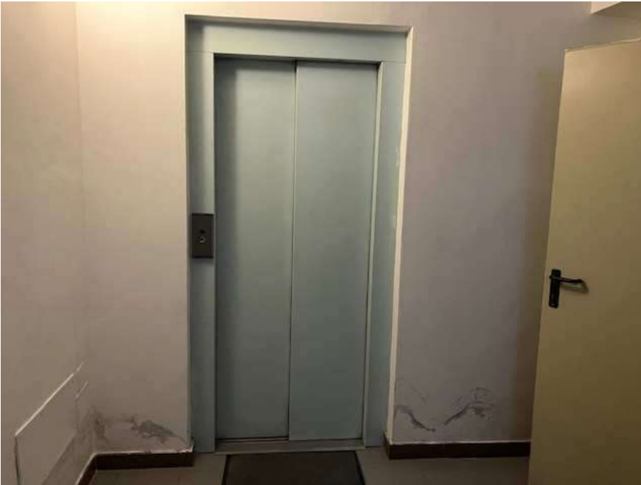
Parti comuni – Ascensore al piano interrato con segni umidità di risalita
