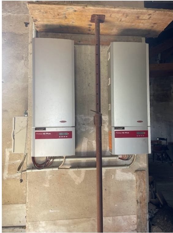
Fotografia A.95 - INVERTERS IMPIANTO FOTOVOLTAICO
