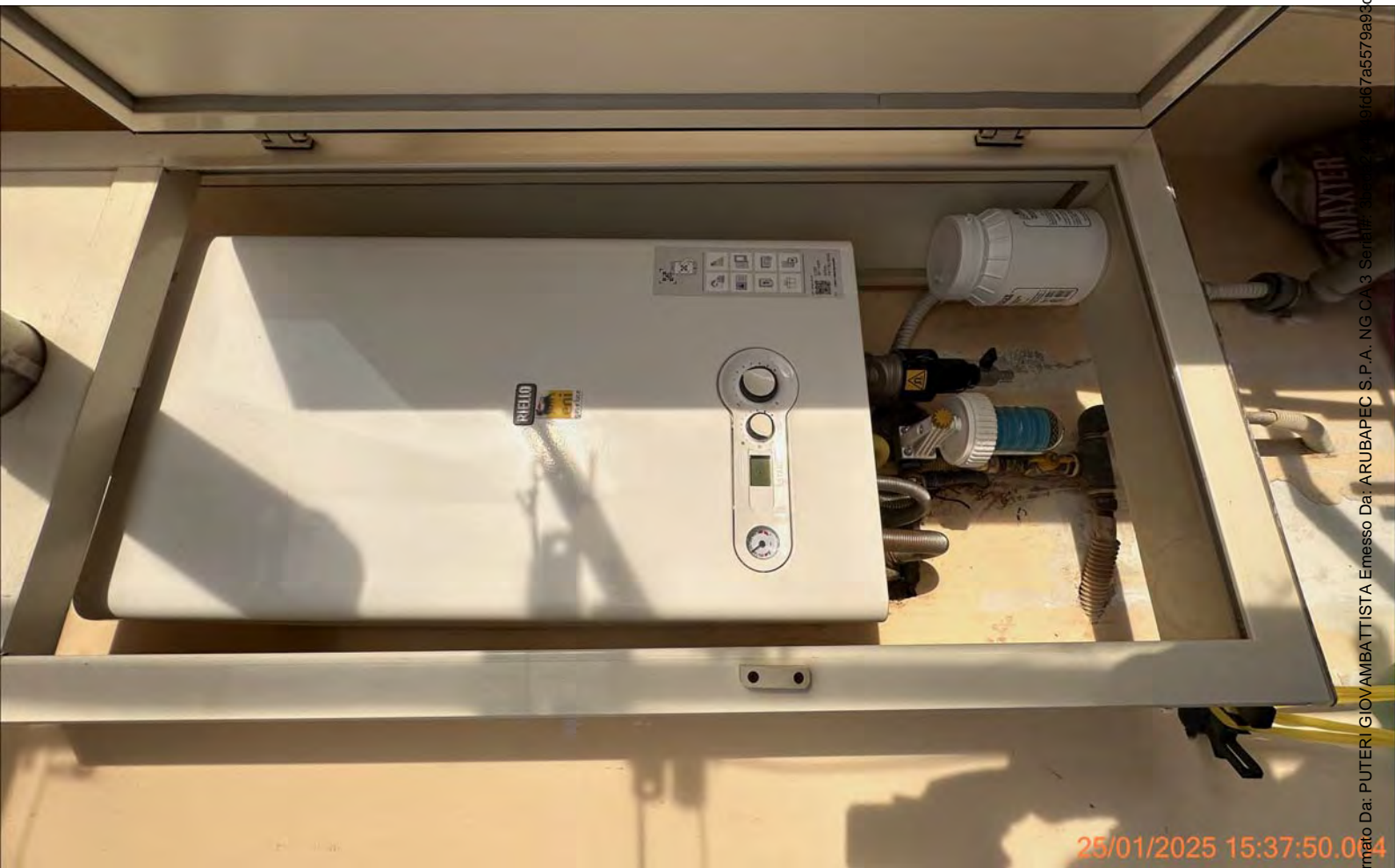
20 particolare caldaia terrazzo cucina.jpg
