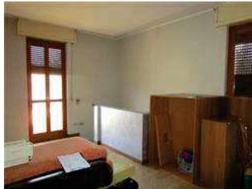
particolare della scala di collegamento ,non autorizzata, soggiorno e cantina
