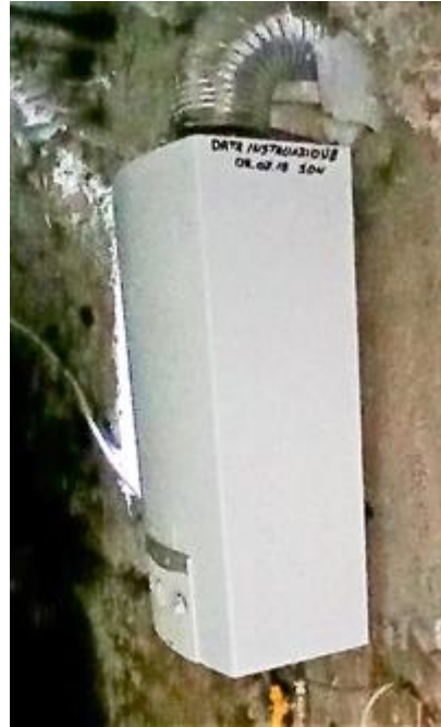
CALDERINA A GAS INSTALLATA NELL'ANNO 2018
