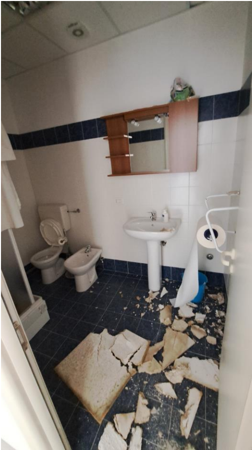
Foto 6 – Distacco cartongesso nel bagno
