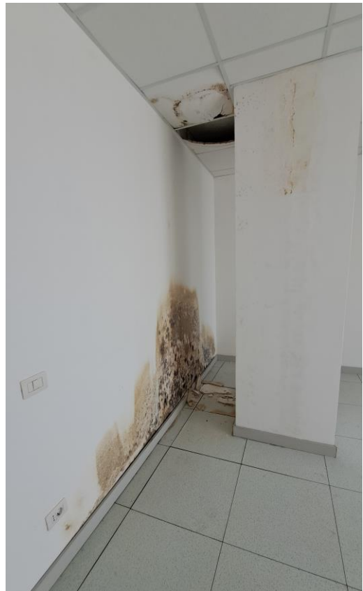
Foto 9 – Particolare ammaloramento parete
