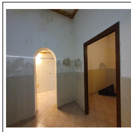
Foto n. 12 tracce delle infiltrazioni umide
