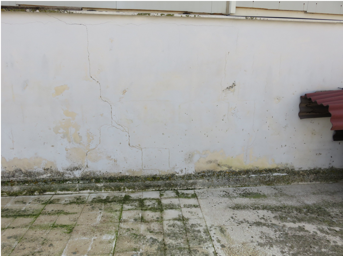
Foto 46 - Terrazzo 2° piano, Particolare scarico causa umidità al soggiorno al 1° p.
