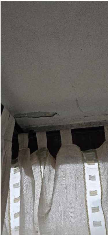
lesioni intonaco soffitto veranda
