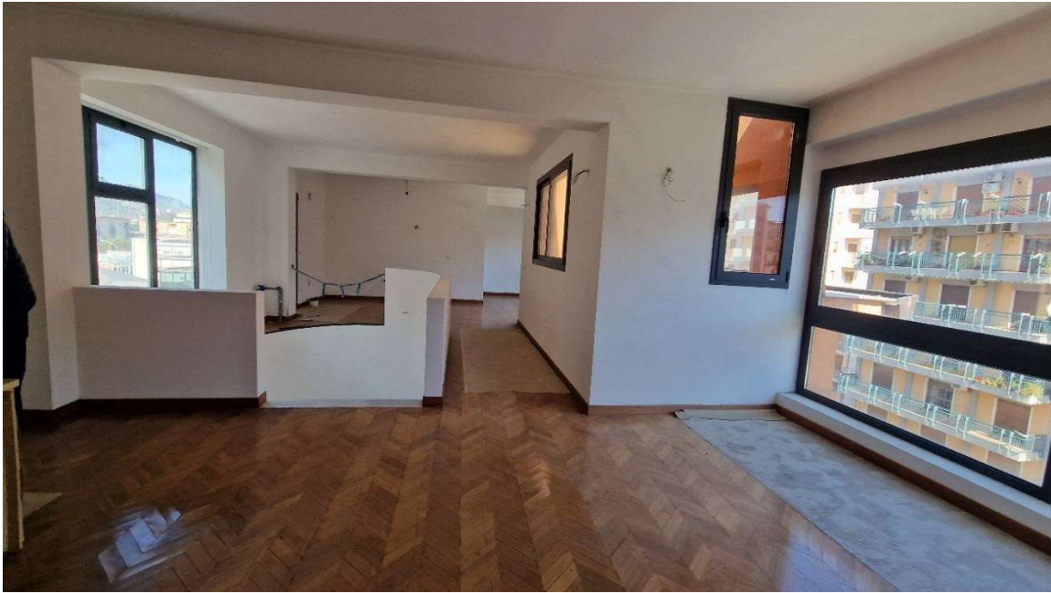
14. Piano 4° - Ambiente unico. A destra, il pozzo luce prospiciente la via F.sco Cilea.
