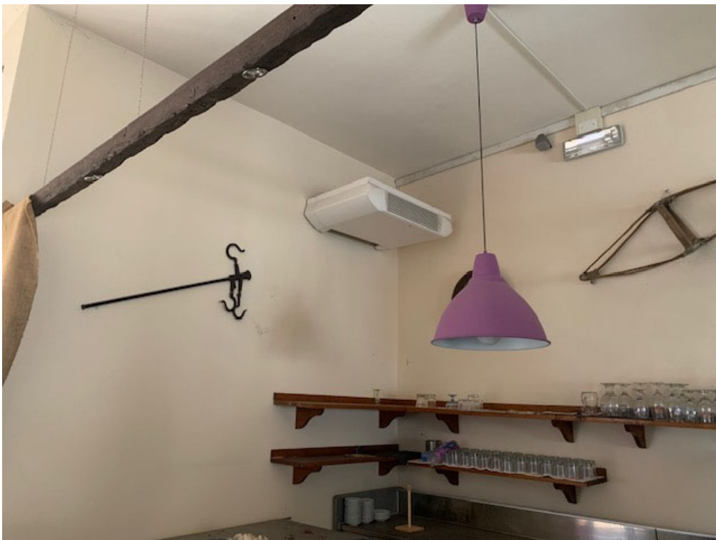
Vista interna sub 36
