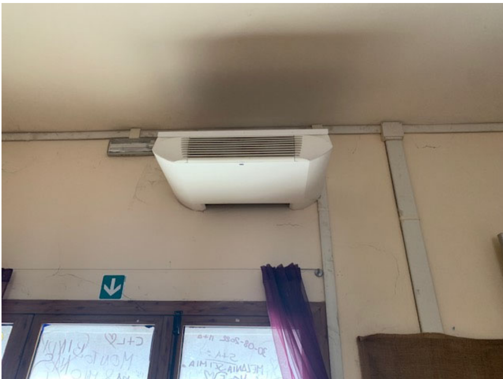
Vista interna sub 36
