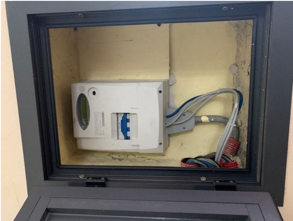
Vista interna sub 36
