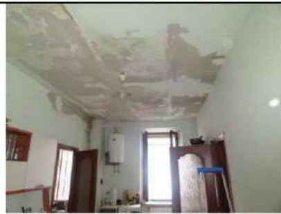
Vista interna, particolare infiltrazioni
