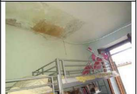
Vista interna, particolare infiltrazioni
