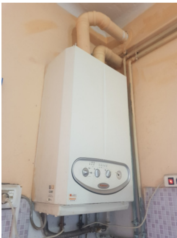
Foto 13 – impianto autonomo - caldaia a condensazione – posta in zona ingresso- tubazioni esterne.
