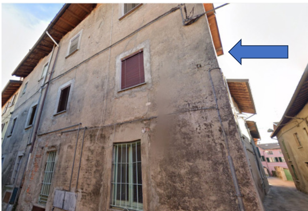
Foto 3 – esterna angolo Via Achille Motta - fronte strada – unità posta a piano primo.
