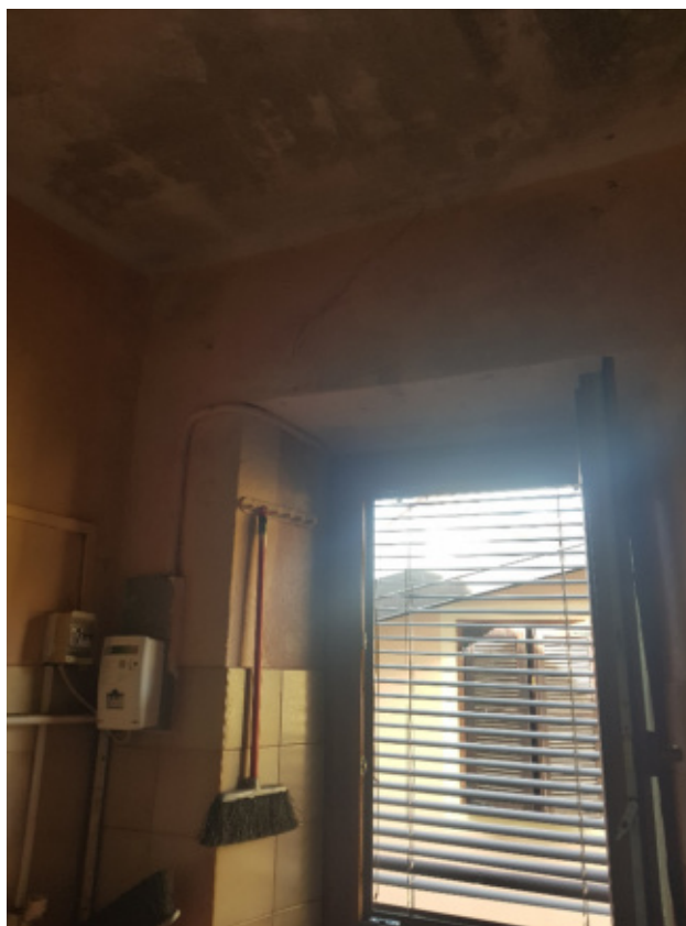
Foto 10 – Locale bagno – aloni – impianto elettrico.
