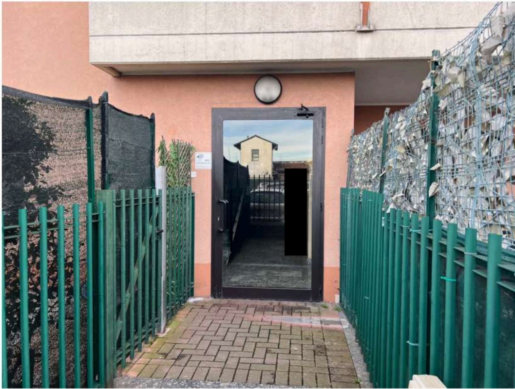
PORTONCINO INGRESSO SCALA CONDOMINIALE
