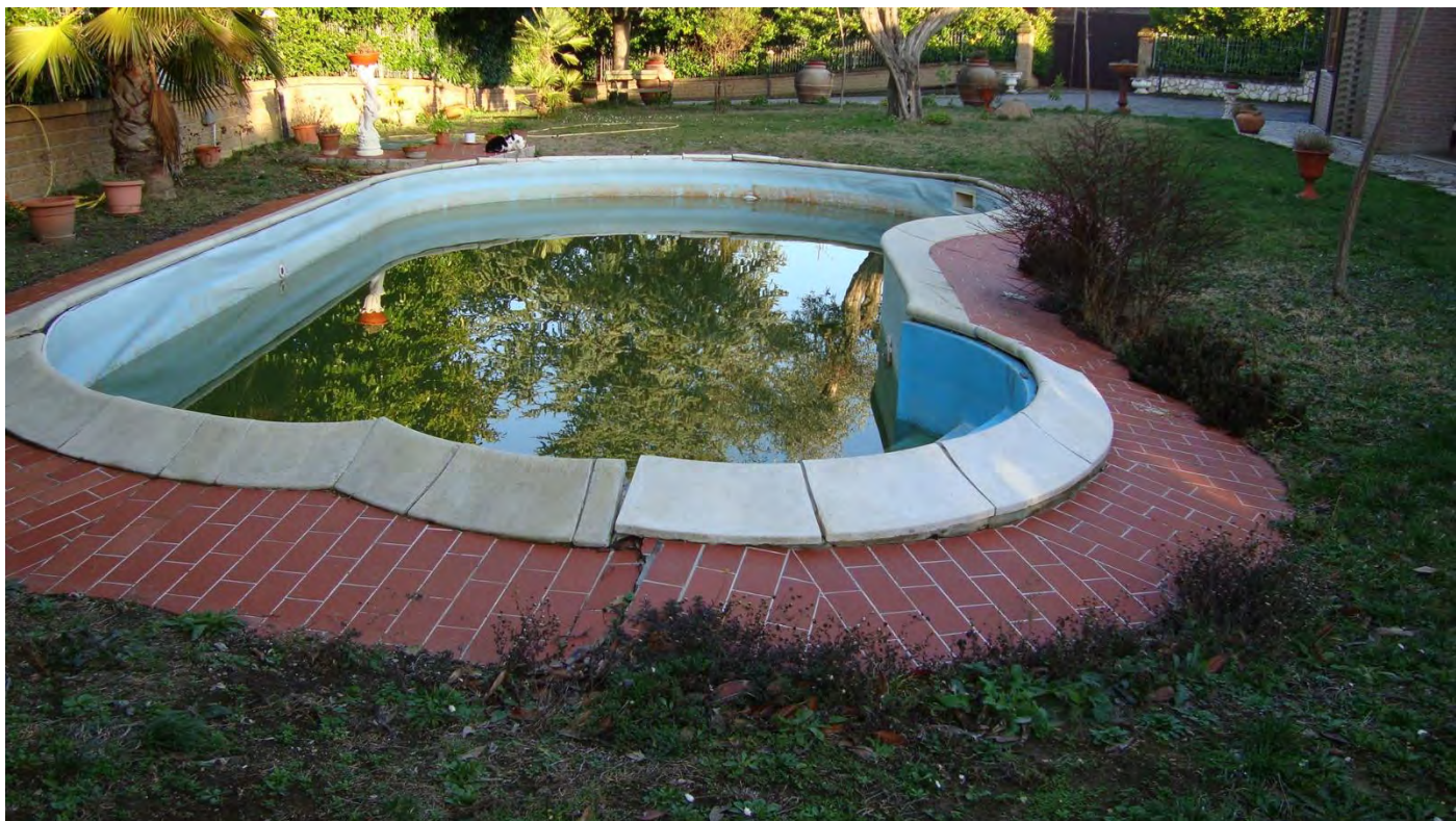
FOTO N. 10 – PISCINA DISSESTATA POSTA ALL'INTERNO DELLA U.I.U. SUB. 7 (CORTE/GIARDINO)
